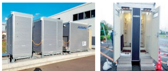
図2 エネルギービークル 西尾工場設置状態
