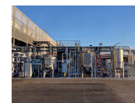
西尾ダイカスト工場 CO 2 分離・回収実証装置
