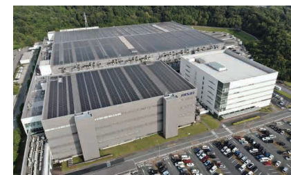
岡崎工場の屋上に設置された太陽光パネル
