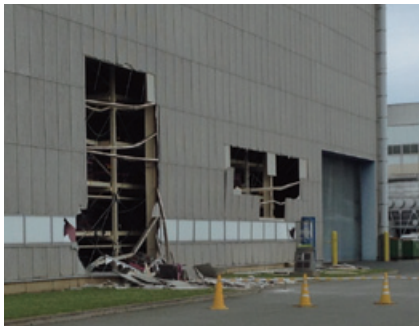
4月16日、本震発生（M7.4,最大震度7）。アイシン九州工場建屋に甚大な被害。金型が壁を突き破って工場外へ落下。
