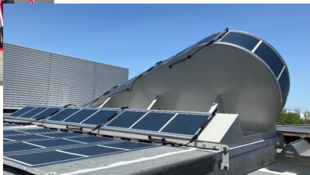
大林組技術研究所屋上に設置された ペロブスカイト太陽電池
